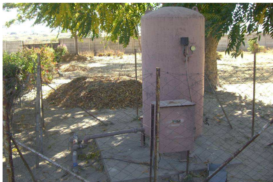
Die marode Wasserpumpenanlage von Bumhudzo
